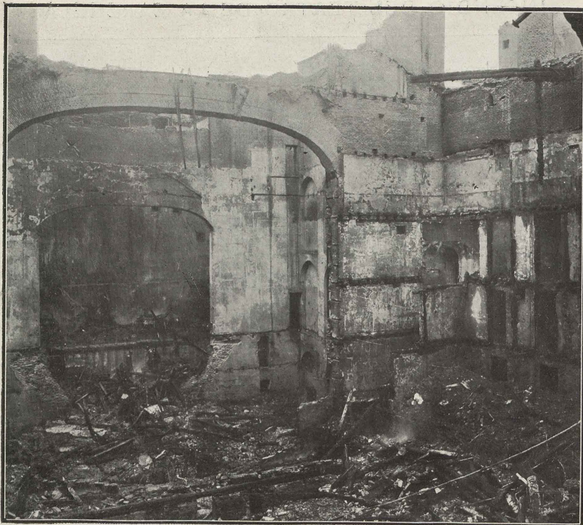
RUINAS DE LA EMBOCADURA Y DEL ESCENARIO
